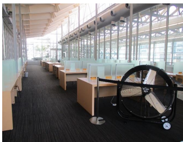
サイレントルームのサーキュレーター
